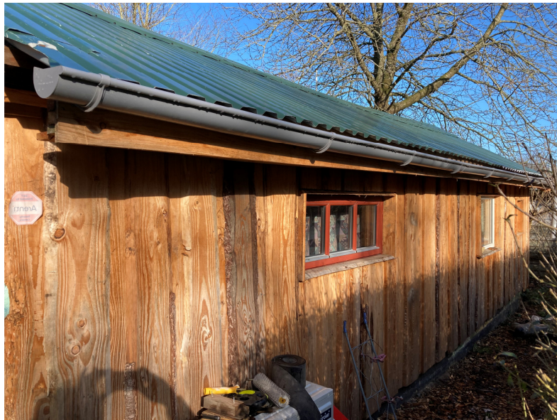
Billede 5 Udhus og beboelse (bygning 2 og 1).
