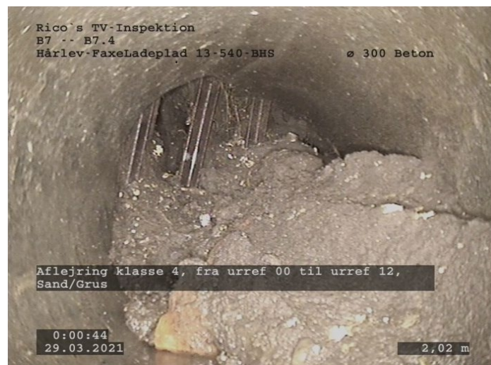
Figur 3 Viser tv-inspektion af eksisterende tilstoppet underføring i ringe tilstand.
